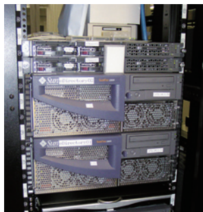
iChainサーバ(上段)とeDirectoryサーバ(下段)をそれぞれ2台ずつ設置し、高い処理能力と可用性を実現している
